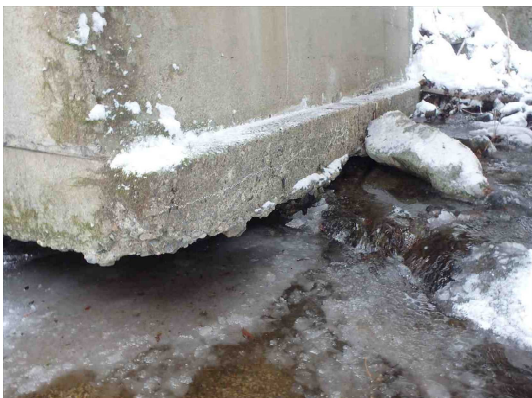
写真4-11 【損傷】橋台の洗掘
