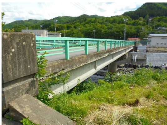
写真4-17 【損傷】地覆剥離
