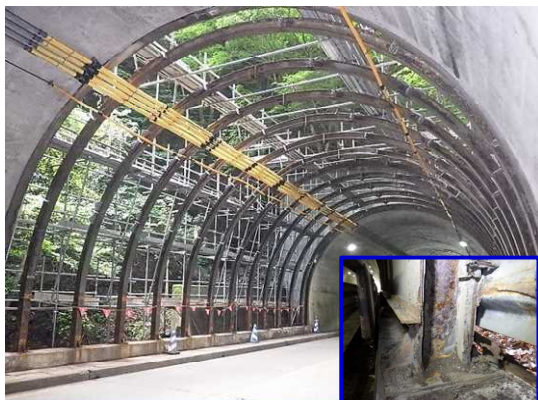
写真4-29 【損傷】主梁の腐食
