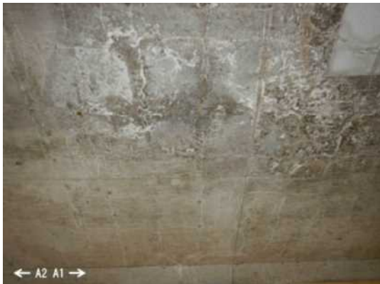
写真4-2 【損傷】床版のひび割れ
