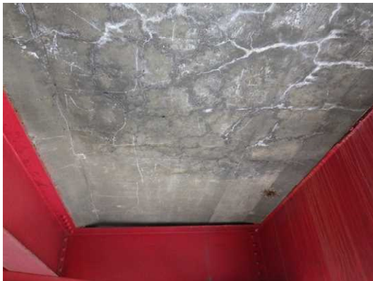
写真4-8 【損傷】 床版ひびわれ、遊離石灰の滲出
