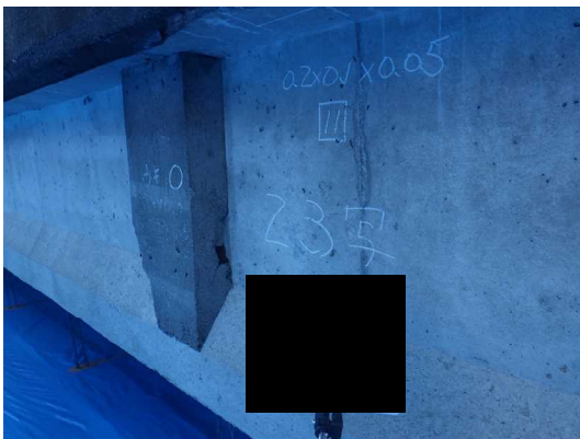
写真4-14 【損傷】 PC鋼材定着部の露出及びうき
