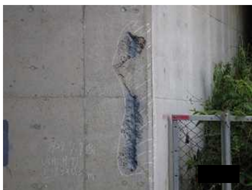
写真4-20 【損傷】 側壁部の浮き（はく落、鉄筋露出）
